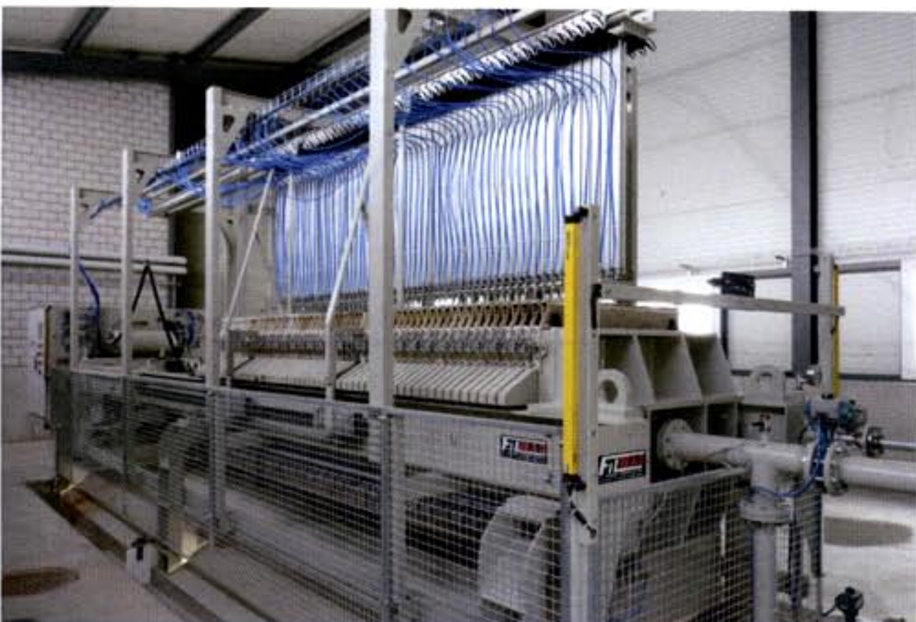
Die Schlammpresse von Filmac-Filtration mit Flüssigbehälter und Druckerzeugeraggregat
